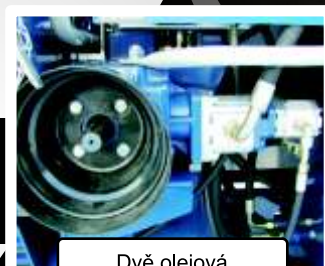
Dvě olejová čerpadla
